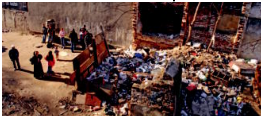
▲ Primăria a interzis accesul în clădirea pe jumătate prăbușită
